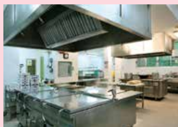
食品厨房設備
