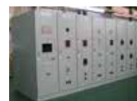
高圧受配電盤 三友エレクトリック(株)
